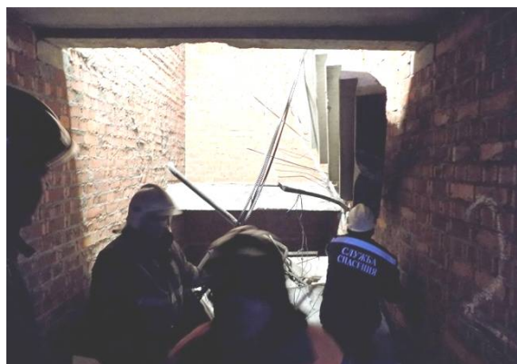
Рис. 5. Обрушение лестничного марша в г. Саранск
