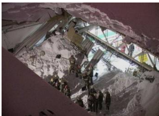
Рис.7. Обрушение кровли гипермаркета «О'КЕЙ», г. Санкт-Петербург
