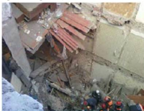
Рис. 8. Обрушение подъезда в г. Ярославле в результате незаконной перепланировки
