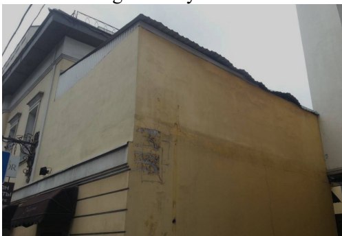
Рис. 4. Выпучивания отделочного покрытия фасада из-за дефектов кровли пристройки и отсутствия водосточной системы
