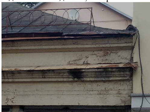
Рис. 3. Неудовлетворительное состояние фасадов одноэтажной пристройки в осях (А/1-Г/1)/(1-4)
