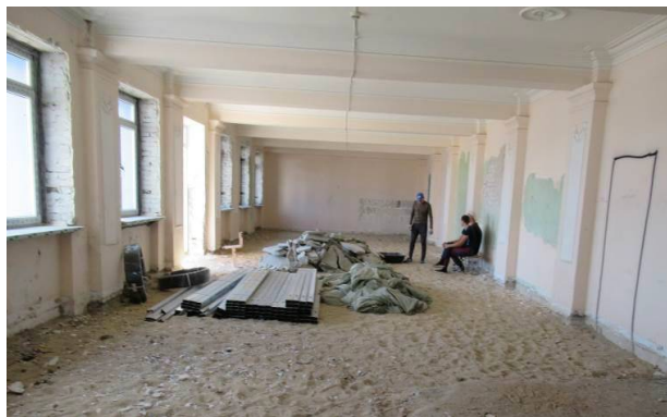
Рис. 2. Балки перекрытия с визуально фиксируемыми прогибами Fig. 2. Floor beams with visually detectable deflections
